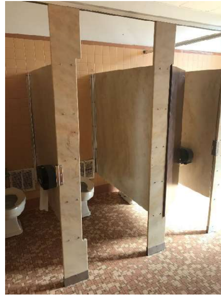
Fig.62 – Missing toilet stall door
